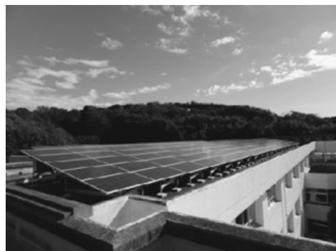
【横浜栄高校に「屋根貸し」で設置された太陽光発電設備】
