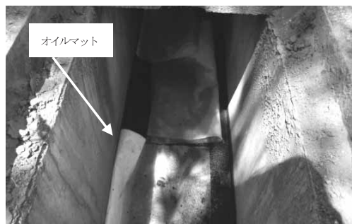
側溝に流出した油
