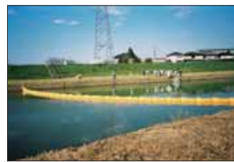
【可搬式オイルフェンスの斜め展開】
