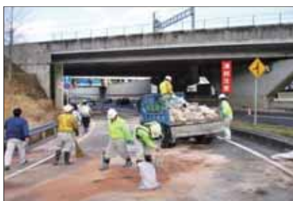
【漏油の回収作業の様子】
