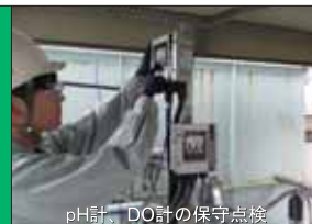
pH計、DO計の保守点検
