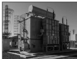
超高压変圧器 (例)
