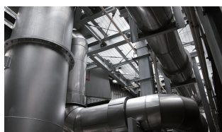
プラント配管
